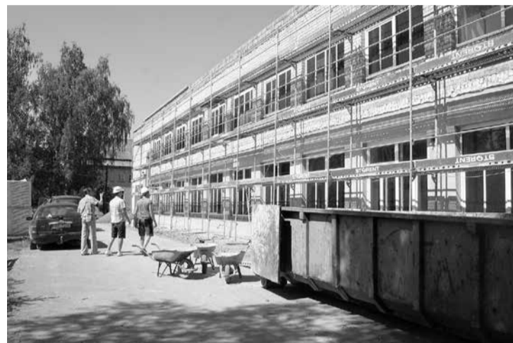
Energoefektivitātes uzlabošanas pasākumi Baumaņu Kārļa Viļķenes pamatskolā.
